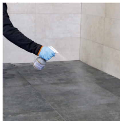
Før siste vask skal PCI Durapox Finish (flytende) sprayes på overflaten etter ca. 60 minutter.
